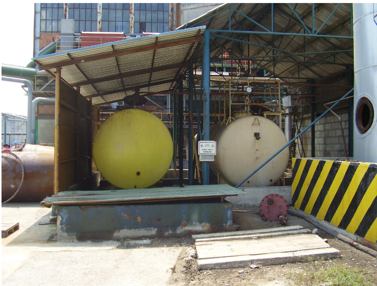
Slika 2. – Rezervoar za sumpornu kiselinu (H 2 SO 4 ) sa betonskom tankvanom
