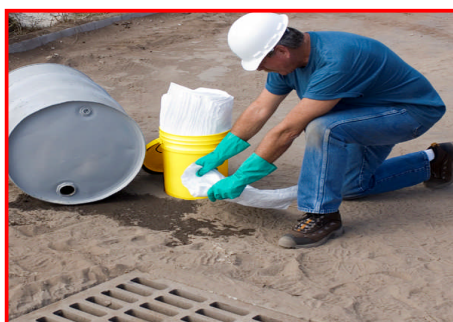
Slika 15. Sanacija malih incidentnih curenja
