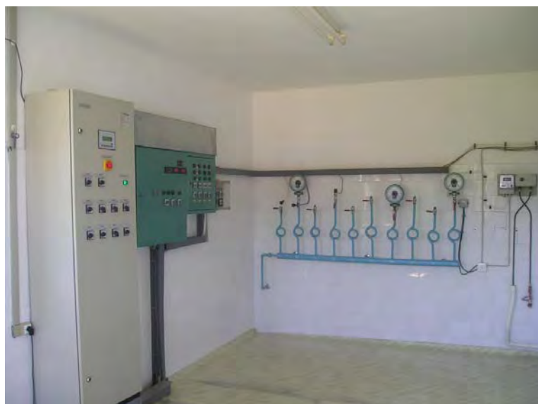
Просторија за даљинско управљање
